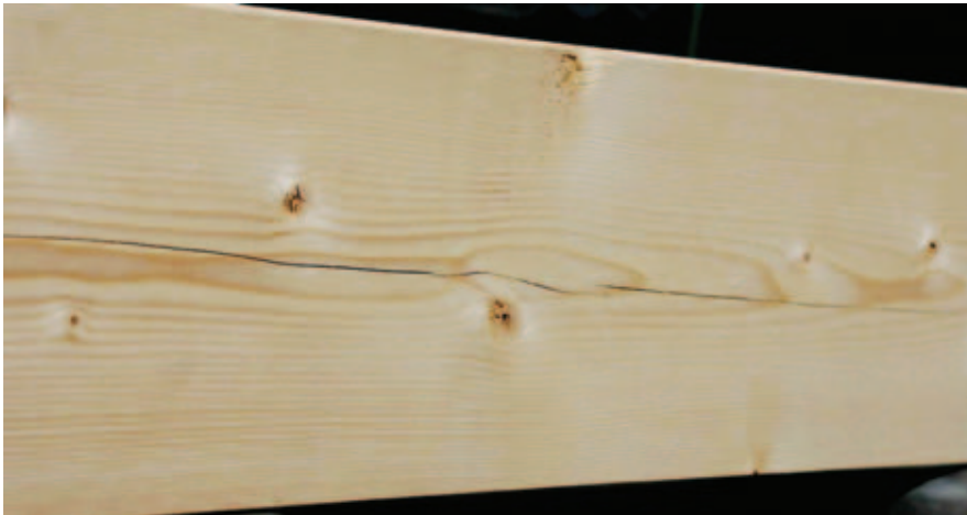
Bild 6 Schwindrisse in einer Decklamelle
